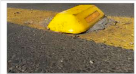
Falta homogeneidad en aplicación del pegamento
