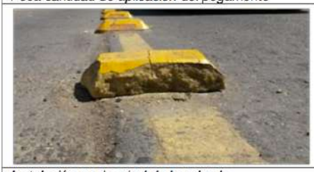
Instalación en desnivel de la calzada
